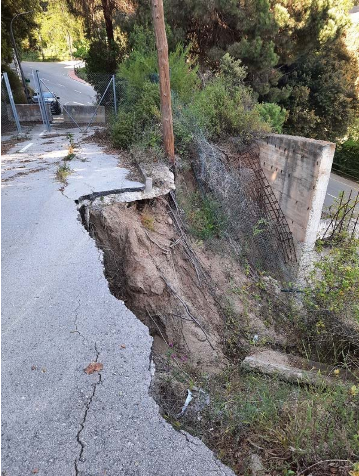
Foto:esvoranc vista cap a nord. Es veu l'estructura de contenció encara en peu i que servirà de suport per a la reconstrucció i restauració del carrer. El poste de formigó queda "penjat del cablejat", ja que s'ha buidat tota la base. Al fons hi ha col.locades tanques i pilones de formigó per evitar el pas a la zona de perill
