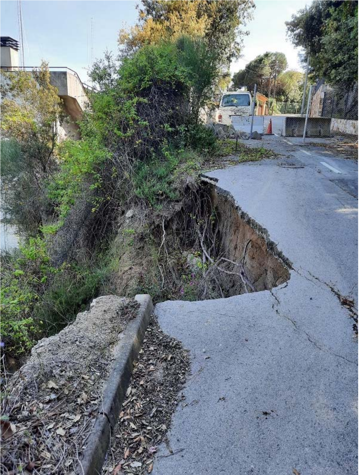
Foto. Esvoranc. El bolc del mur s'ha endut part del carrer, calçada , vorada i vorera
