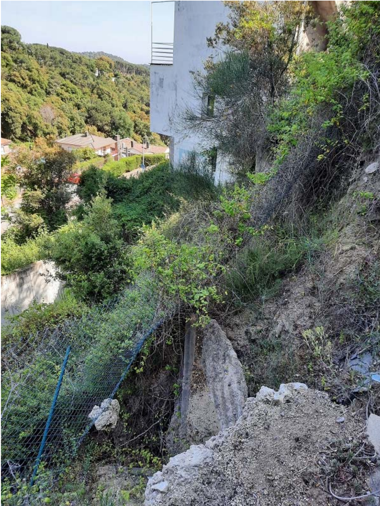
Foto: esllavissada des del carrer Moreres cap a la finca sota rasant del carrer. Al fons el mur bolcat, al front la tanca també s'ha esllavissat amb les terres
