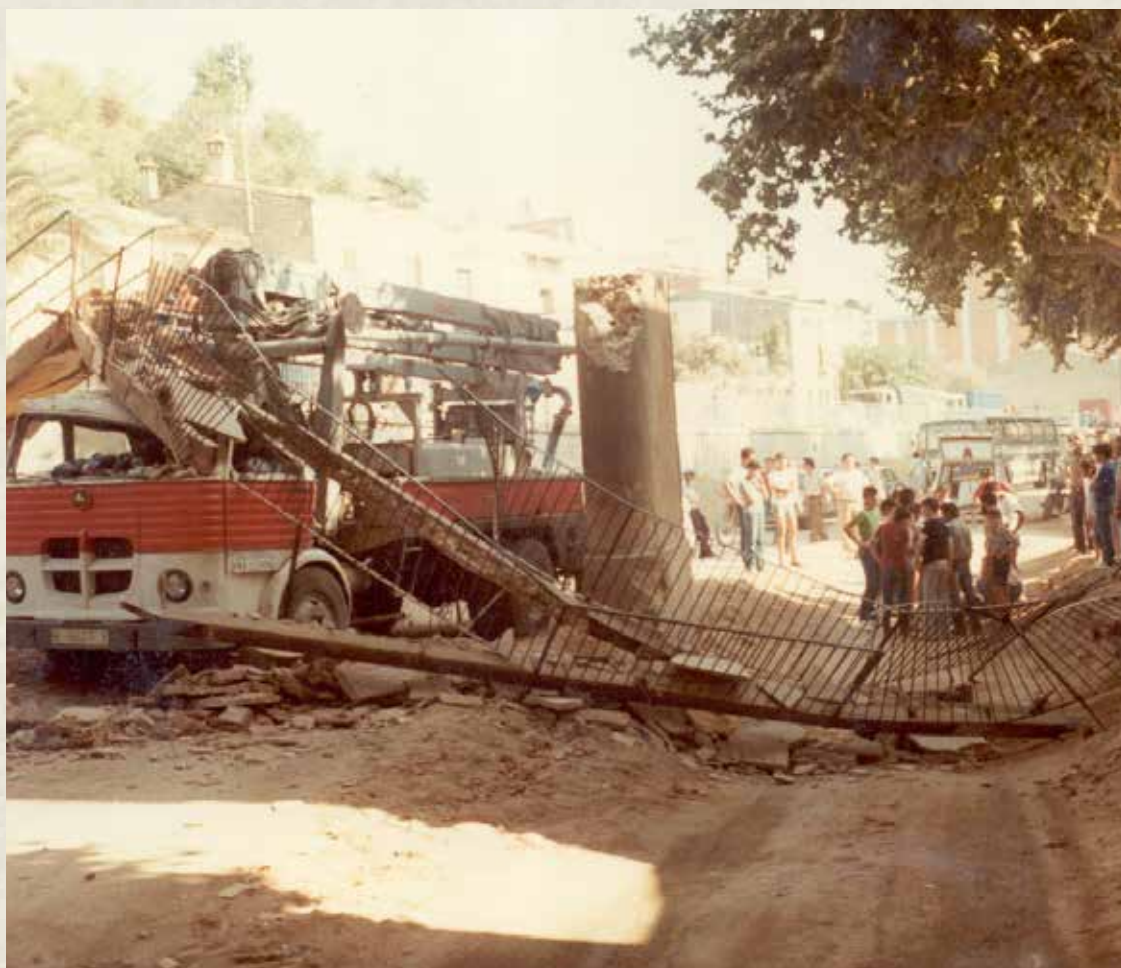
Accident del pont de la Riera
